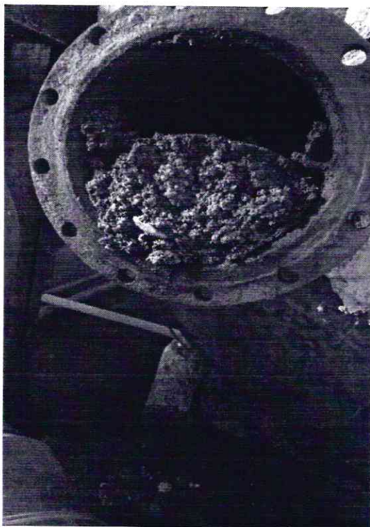
Фото 1 – трубопровод подачи обратного рассола из цеха-потребителя Е-1-9а-12 в испаритель поз.3/9 отд. Ж-7
